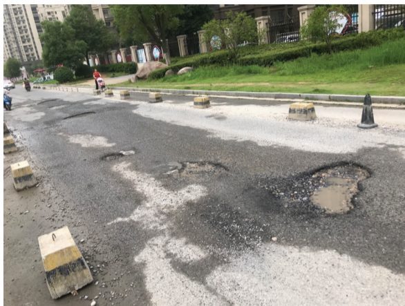
凯迪塞纳河畔小区东门口的路面破损严重。
