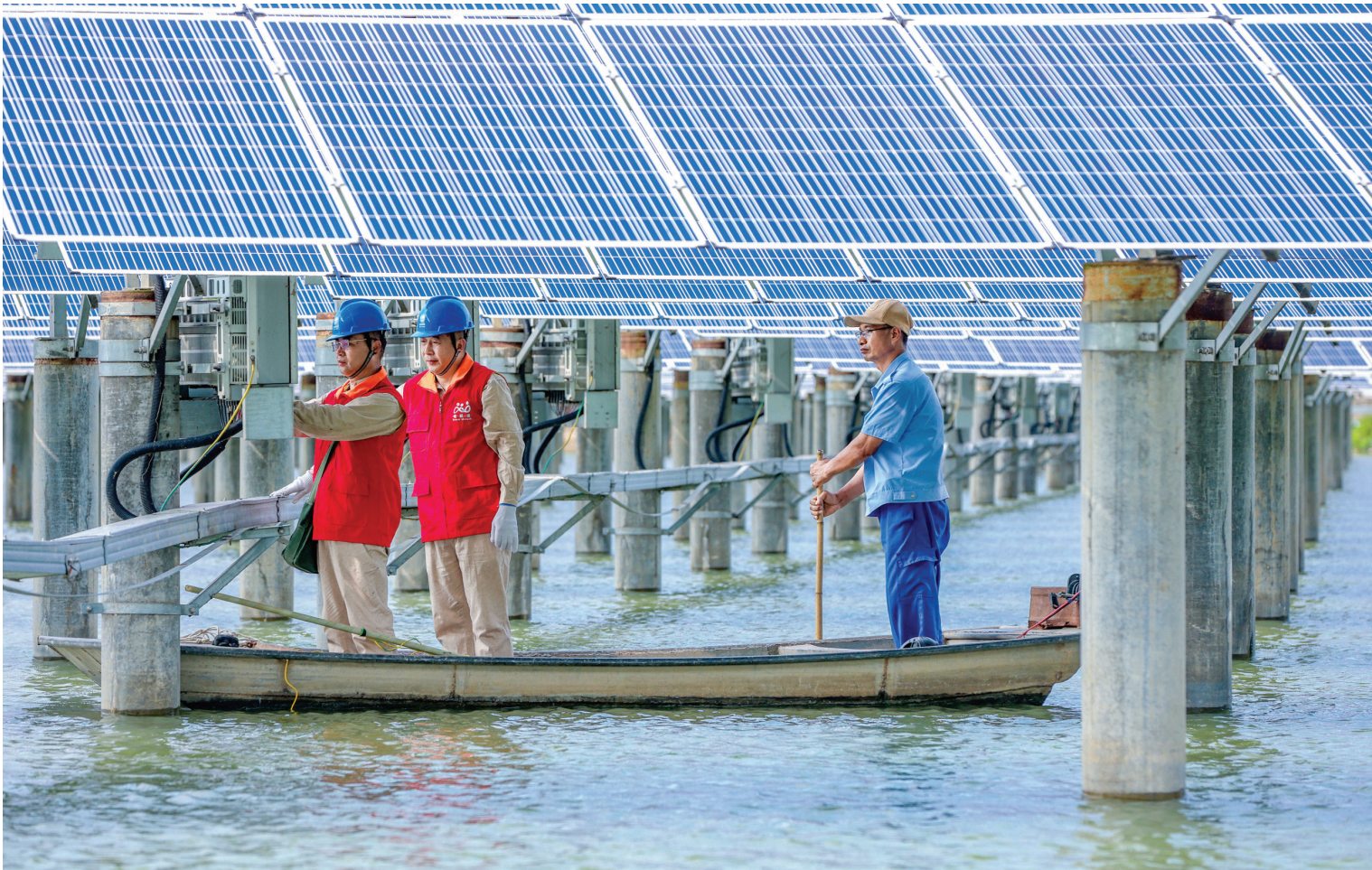
8月19日,在江苏省扬州市邗江区公道镇,电力运维工人在检查渔光互补发电设备运行情况。国网江苏省电力有限公司最新统计数据,截至2026年7月底,江苏省光伏发电累计装机容量突破1亿千瓦,达10008万千瓦,占全省电力总装机量的比重超38%,超过煤电、气电和风电等,成为全省第一大电源。
