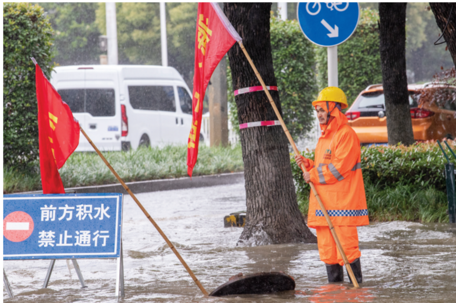
6月22日,雨中,工作人员踏过路面积水,撬开窨井盖,清理篦子上淤积的落叶杂物,全力疏通排水通道,加速路面积水下排。
