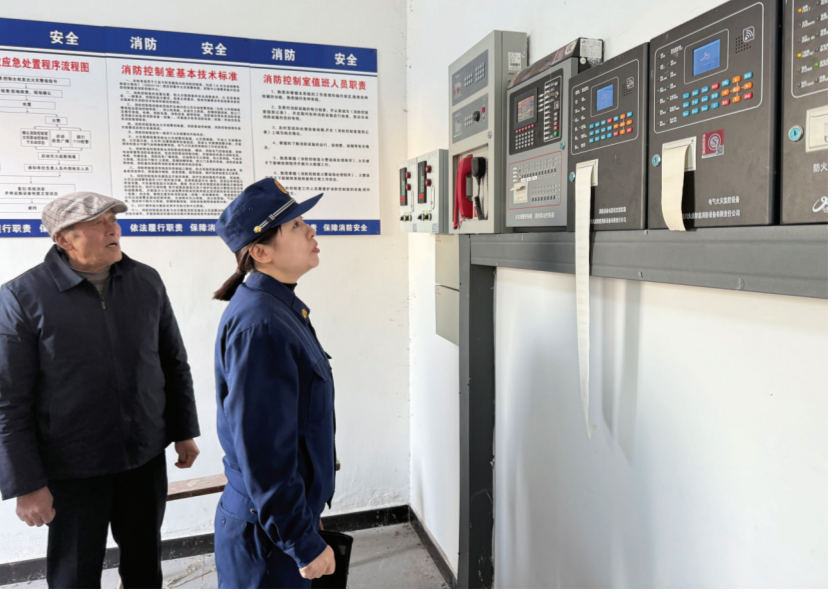
近日,区委统战部联合区消防救援大队、乌衣镇深入辖区宗教场所开展消防安全专项检查,查看消防设施运行、消防通道及用火用电规范等情况,并就隐患整改提出指导意见,全面排查风险隐患,筑牢安全防线。 许平 董超报
