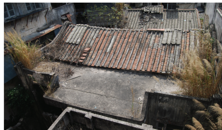
中央红色交通线旧址(汕头站)修复前的屋顶。(图片由汕头市金平区文化馆提供)
