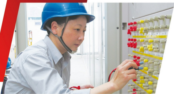
主变投运前,检查核对主变保护屏压板状态
