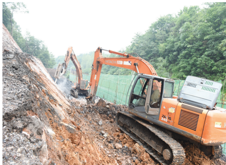
受强降雨影响,南谯区施集镇花山村部分山区地段出现滑坡现象。为及时做好地质灾害防治工作,该区及时调集人员、机械对滑坡山体进行整治加固,消除安全隐患,切实保护人民群众生命财产安全。董超摄
