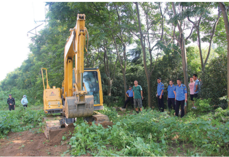
为全面掀起决胜全国文明城市争创热潮,进一步展现和提升小区文明创建形象,8月24日下午,琅琊区城管执法局西涧城管中队联合社区依法对西涧花园小区院墙西侧破坏绿化违规种菜行为进行专项清理,现场动用机械共清除、平整菜地约1000平方米,清运乱搭乱建4处。温仕兵摄
